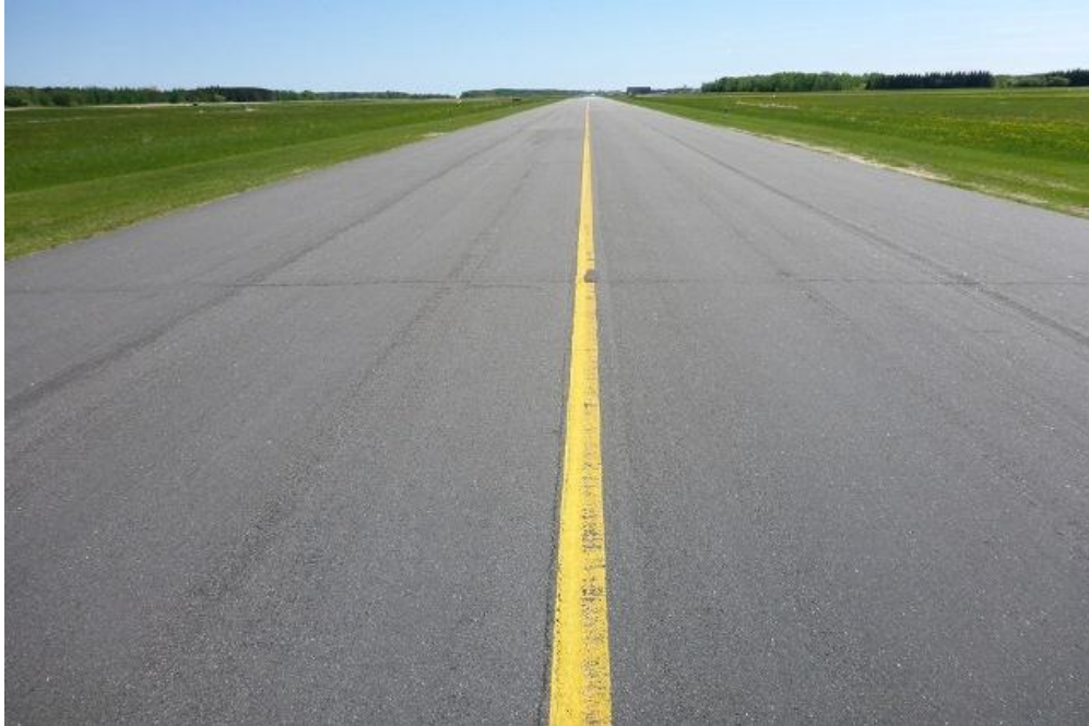
RRT PTA 001 (PCI = 71)
